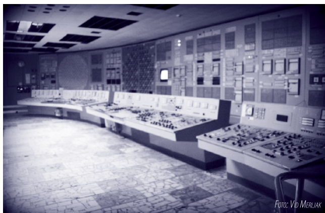
Pogled v kontrolno sobo bloka 2.
